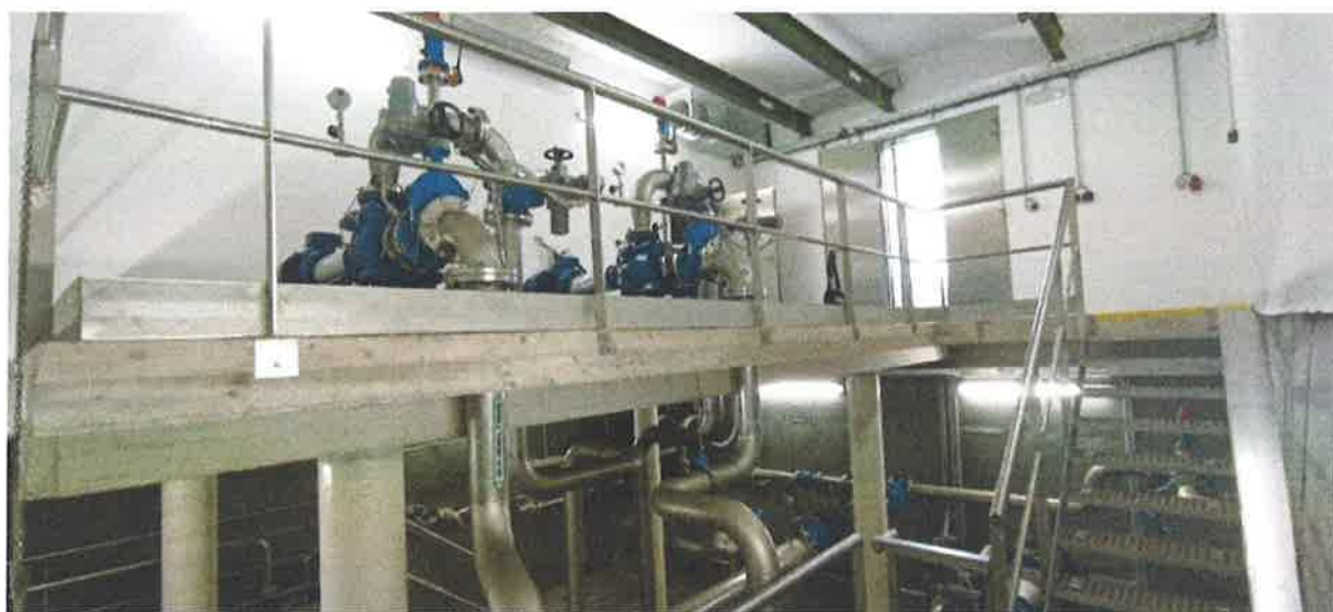
Malá vodní elektrárna na přivaděči VSVC Police nad Metují
