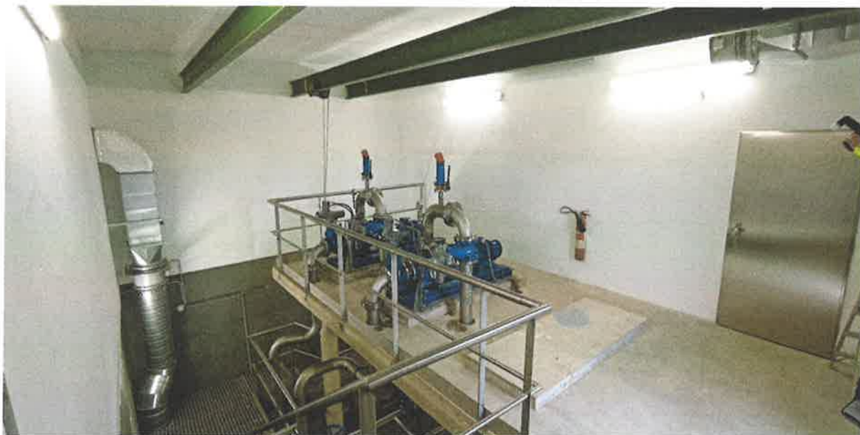
Malá vodní elektrárna na přivaděči VSVC Police nad Metují
